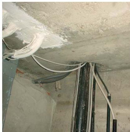
Ausführungsmängel in einer F 90-Massivdecke:
