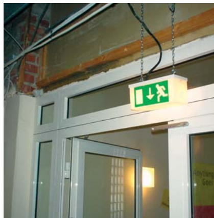
Nach Ausbau der nicht klassifizierten Unterdecke: Fehlende F 90-Wand oberhalb der T 30-RS Tür
