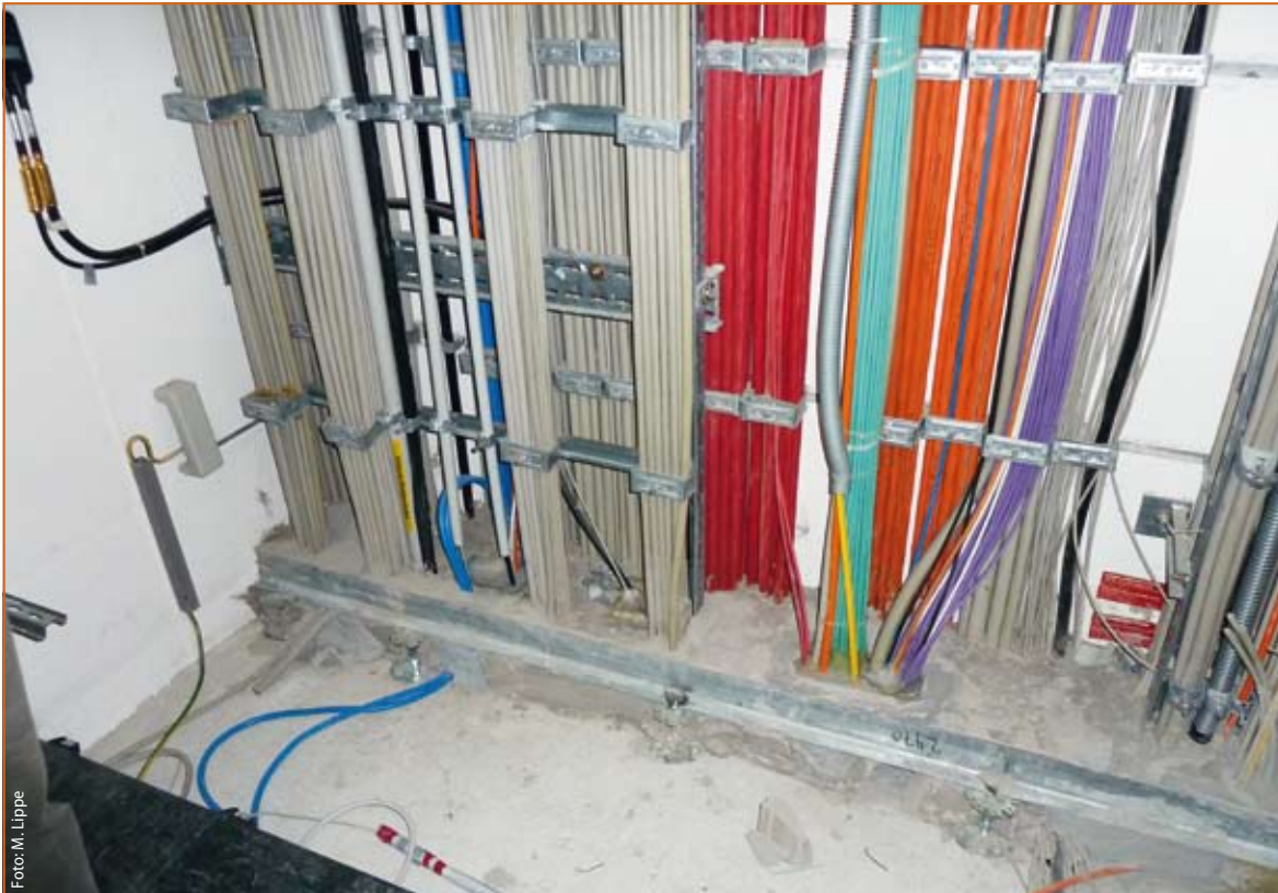
Abb. 1: Elektro-Abschottung zwischen Technikzentralen, ausgeführt als S 90-Mörtelschott und S 90-Kabelboxen.
