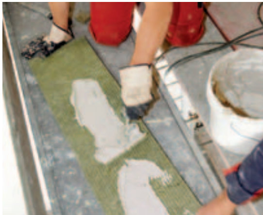
c) Aufbringen des Conlit Fix auf die Bekleidung. Normalerweise würde ein raupenförmiger Auftrag ausreichen.
